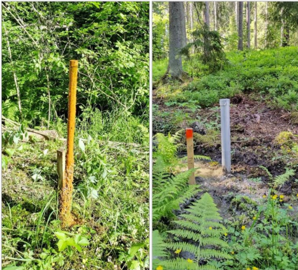
Kuva 28. Vasemmalla Kissanojan eteläpuolella sijaitseva vanha havaintoputki PVP23 sekä oikealla keväällä 2022 asennettu havaintoputki PVP306 (Kuvat © Sitowise 2022).
